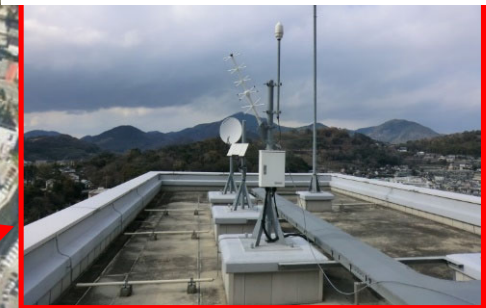
合同庁舎屋上の衛星アンテナ
