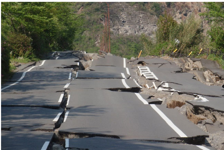
亀裂の入った道路(南阿蘇村立野)(南阿蘇村提供)
