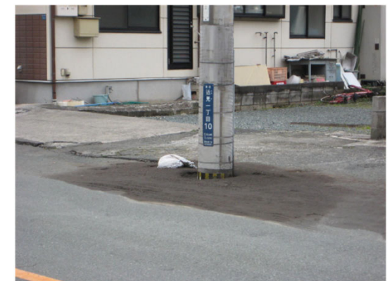
沈下した電柱
