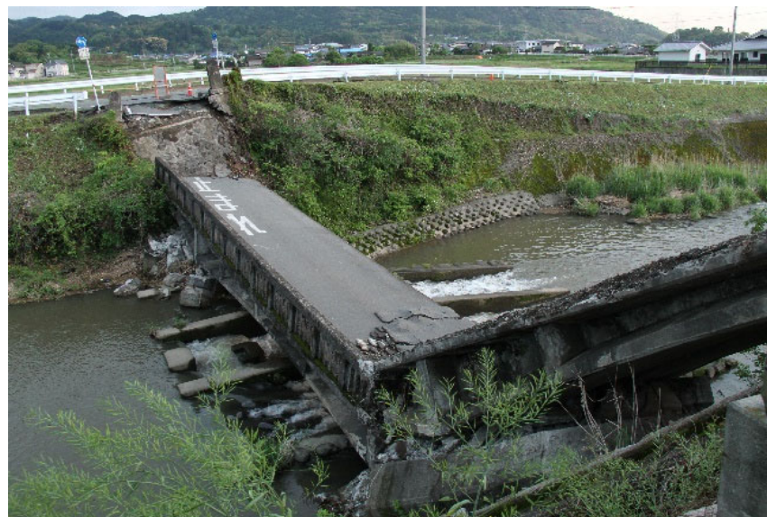
崩れた橋(益城町福原)(益城町提供)
