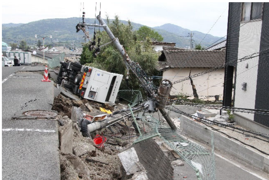
崩壊した法面(益城町宮園)(益城町提供)
